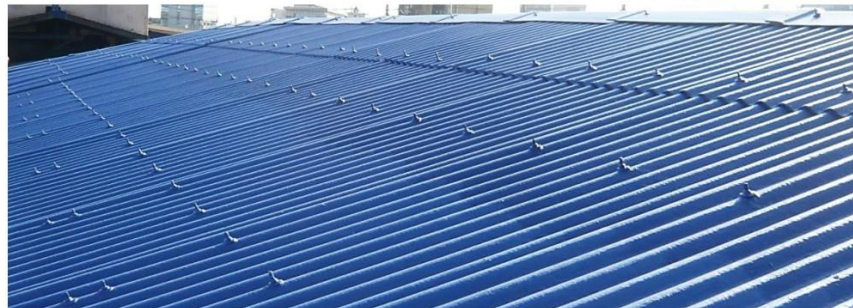
(8)大阪府 老朽スレート屋根
