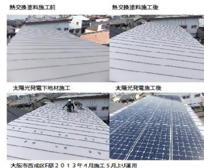
大阪市西成区F邸 2013年4月施工5月より運用
